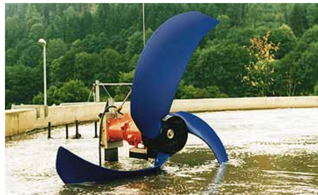
Halb aufgetauchtes Propellerrührwerk
